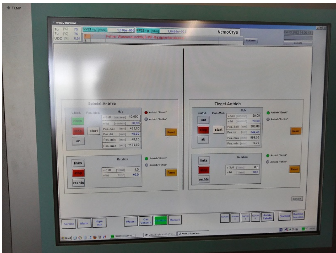
Abbildung 54: Bildschirm des Schaltschranks der Test-CZ Anlage (Quelle: eigene Darstellung)
